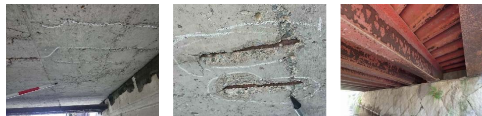
コンクリートのひびわれ
