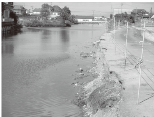
豪雨災害により被災した道路 (酒見地区)
